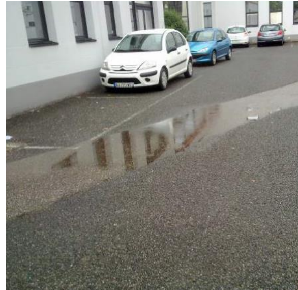
Stagnation des eaux pluviales
